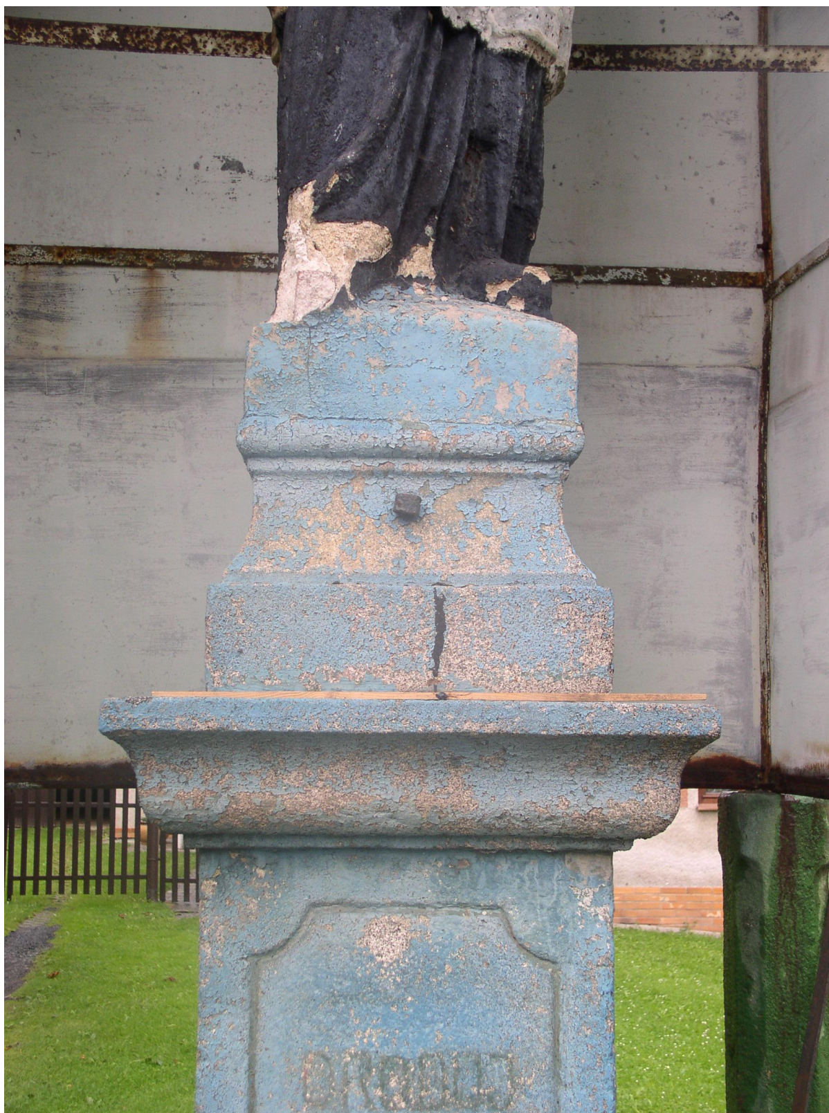
Hlavice soklu a detail poškození spodní části sochy
